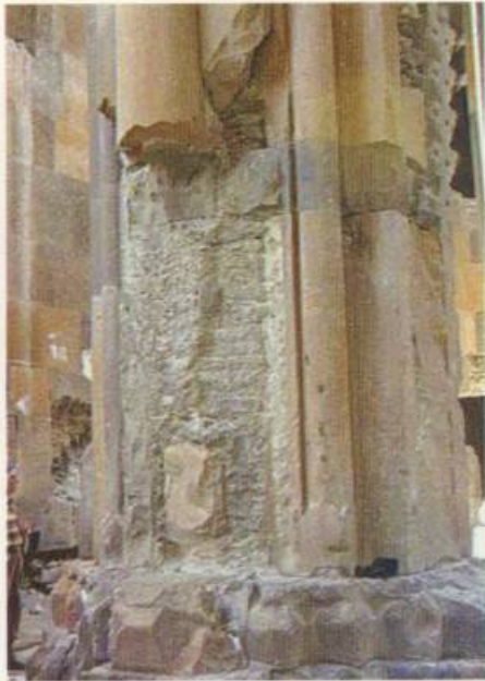
Եկեղեցու սիւների քարերը ջարդելով թուլացնում են նրա հիմքերը, որպէսզի խորտակւի կառոյցը: با هدف فروریختن کلیسا ستونهای اصلی آن را تخریب می نمایند For destroying of church, they demolish the columns.
